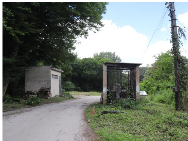
Az elektromos trafóház és a hulladéktároló
